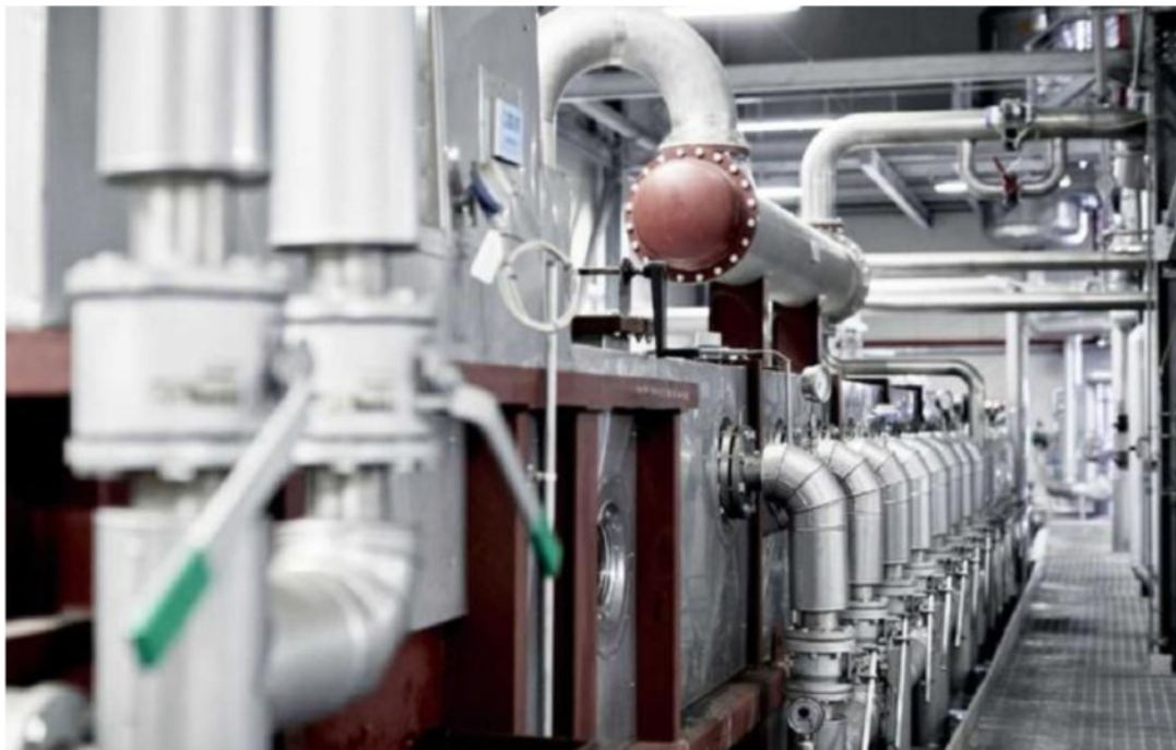
Uno scorcio dell'impianto della Cereal Docks a Camisano: funziona la produzione di vapore con olio vegetale puro di soia
